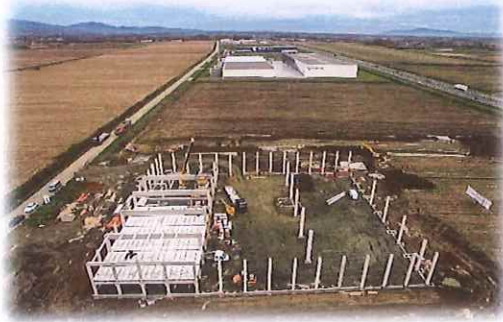
Slika 17: Izgradnja Tehnološkog inkubatora u Novoj Gradiški - foto: Industrijski park Nova Gradiška d.o.o.
